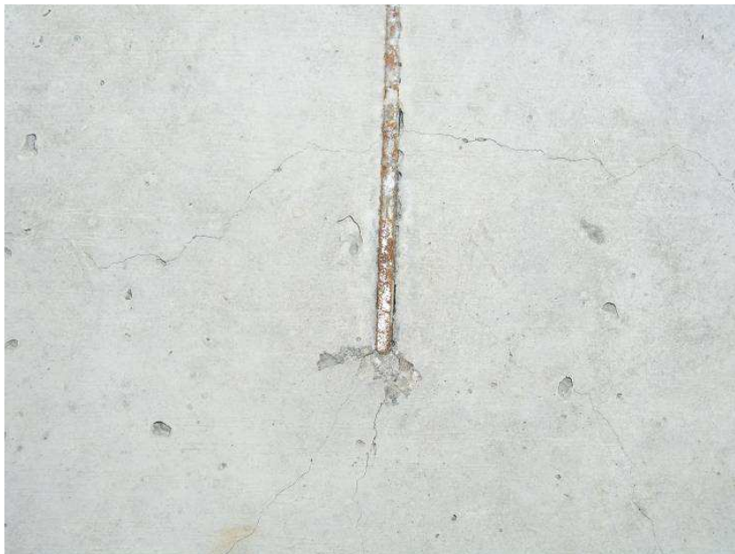
Obr. 7: Drčení betonu v patě lišty
