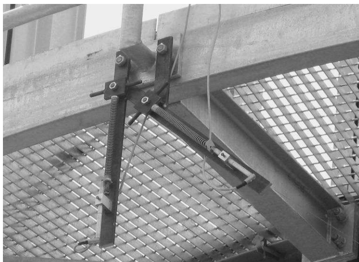
Obr. 10.: Uchycení snímačů na konstrukci věže radaru
