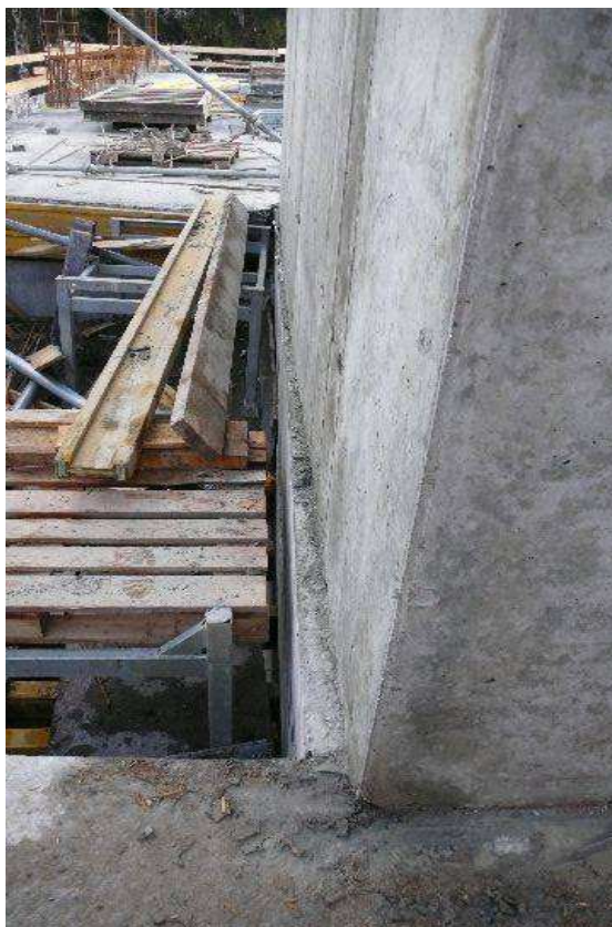
Obr. 1.: Posunutí stěny výtahové šachty vinou špatného ukotvení bednění
