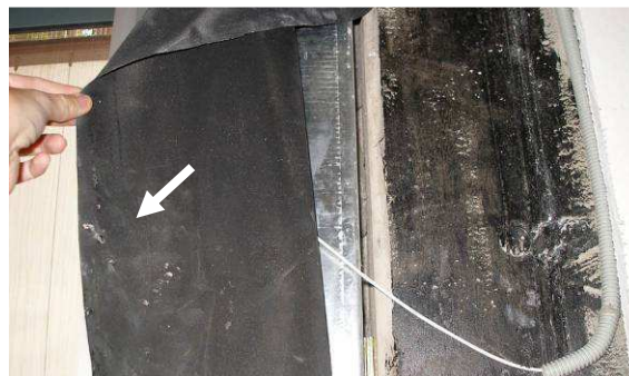
Obr. 11.: Penetrované ostění okna, na odtržené části fólie je patrné, že nebyla na ostění takřka vůbec přilepena
