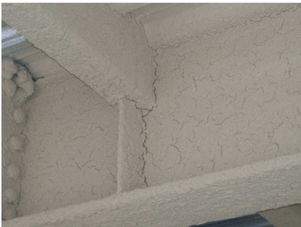
Obr. 1.: Trhliny protipožárního nástříku
