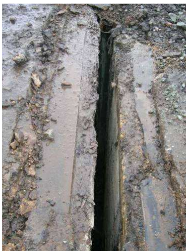
Obr. 3.: Odhalená podélná spára mezi nosníky již bez krycího plechu
