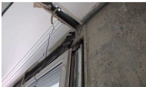
Obr. 8.: Ostění okna bez penetrace a odříznutá systémová fólie
