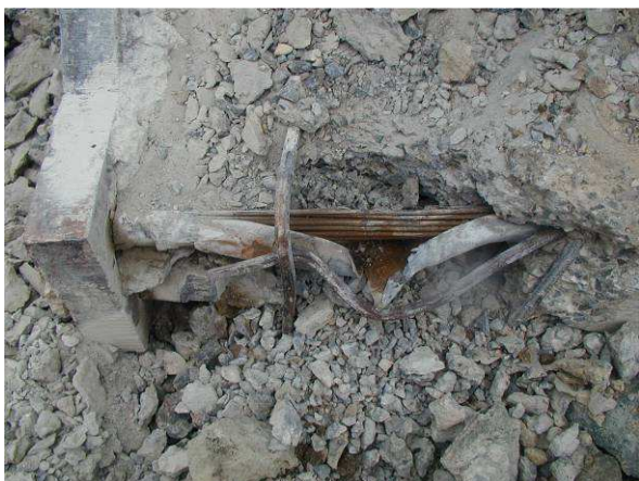
Obr. 5.: Koroze předpínací výztuže v kotevní oblasti pravého nosníku
