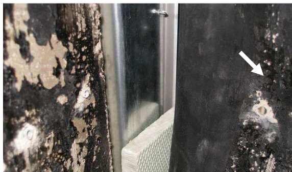
Obr. 10.: Penetrované ostění okna, na odtržené části fólie je patrné, že byla přilepena na ostění
